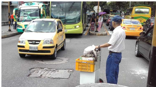
Figura 21. Presencia de un bache en la Carrera 33 con Calle 52. Fuente: Autores.
