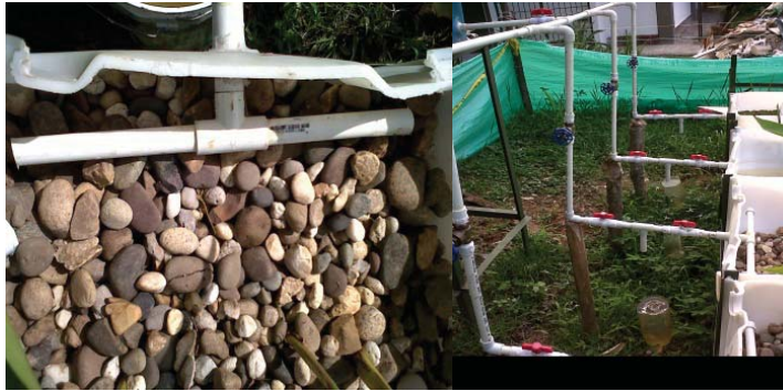
Figura 3. Sistema del Modelo 2 para descarga del agua residual en el piloto humedales artificiales. Fuente: Quintero y García, 2012.
