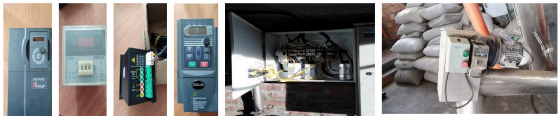
Figura 7: Controladores industriales para los equipos, sus respectivas cajas de control junto a la planta alterna de energía
